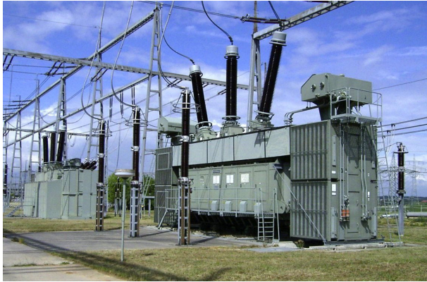
Transformateur de puissance (triphase) ERDF
